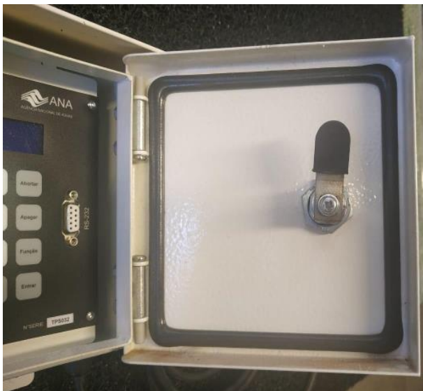
Figura 5 – Imagen interna de la puerta de la carcasa
